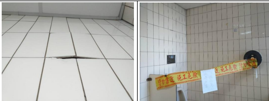
4 樓西側男廁小便斗正上方磁磚膨脹(修復中)
