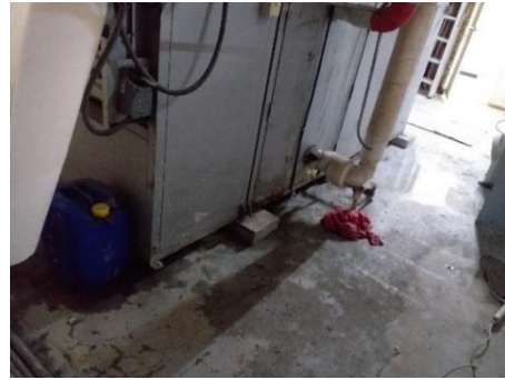
1F 東北空調機房地板滲水
